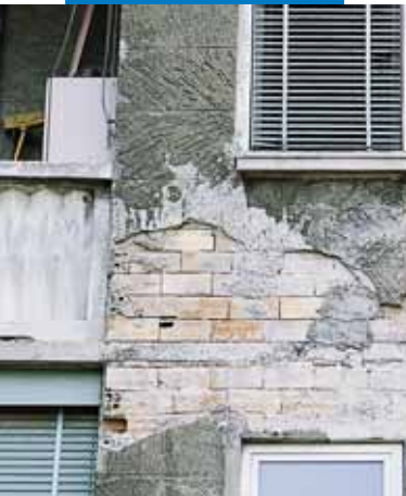
Ēkas fasāde, kurai nepieciešams remonts
