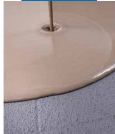
Pašizlīdzinoša sastāva uzklāšana Uniplan Eco uz nožuvuša Eco Prim Grip Plus, kas uzklāts uz vecās grīdas
